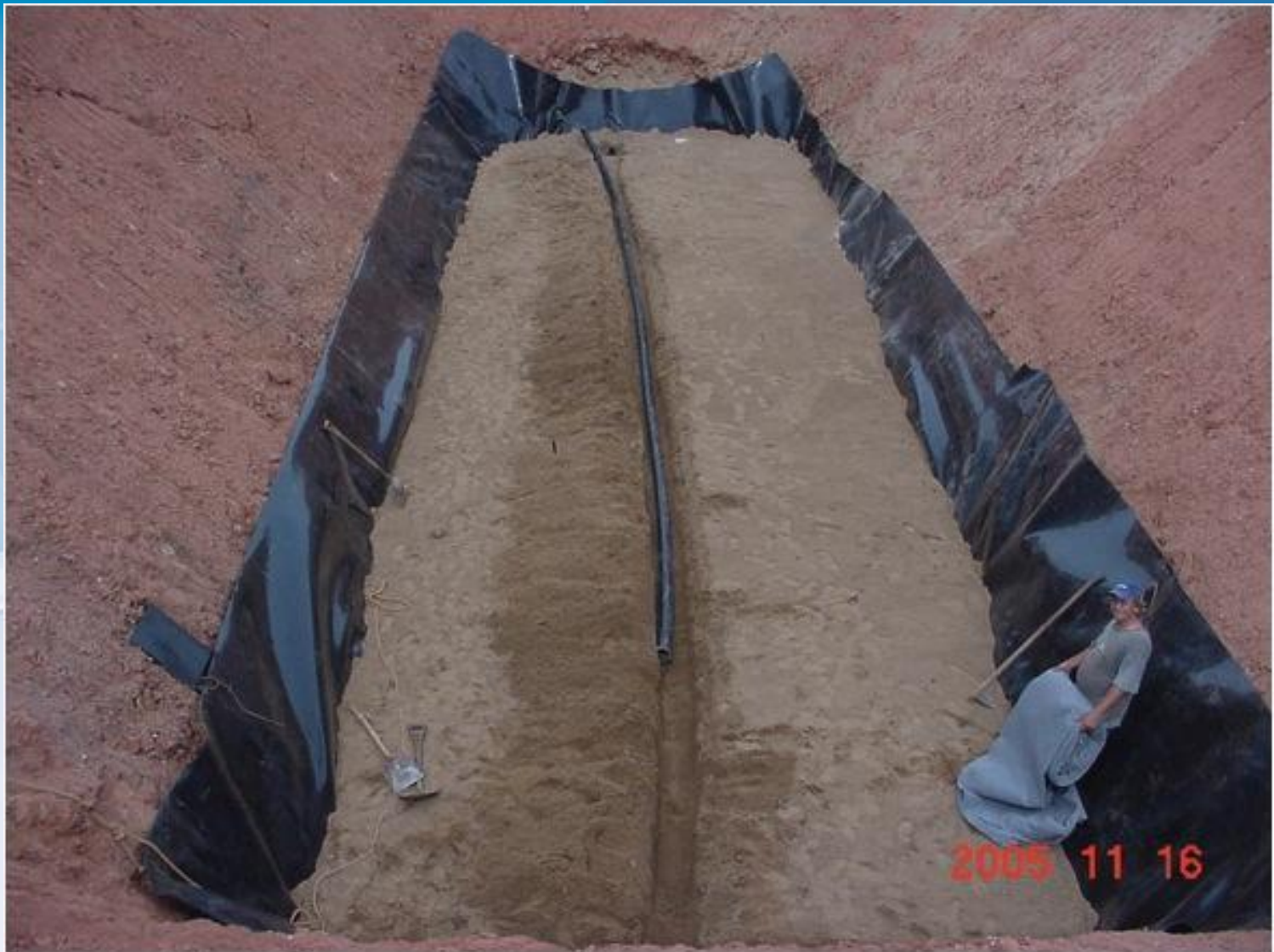
Monitoreo de fugas
