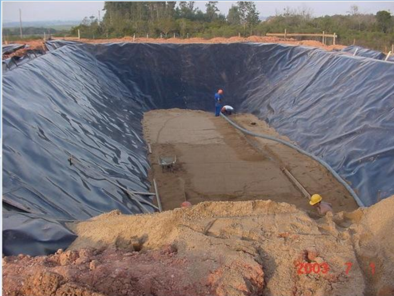
Drenaje de lixiviado
